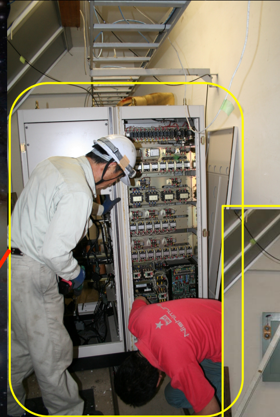
パワーリレー室
