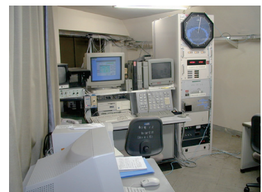
図4. 改修前の制御室
